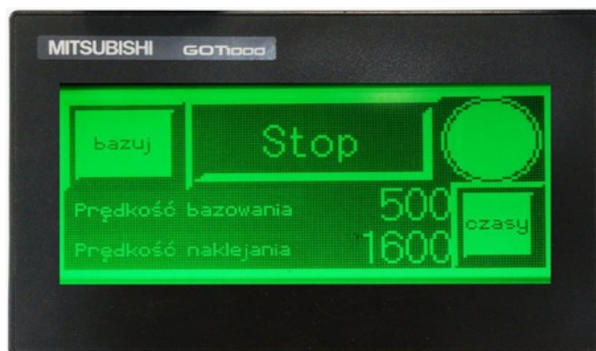
Фото 10. Главная панель II
